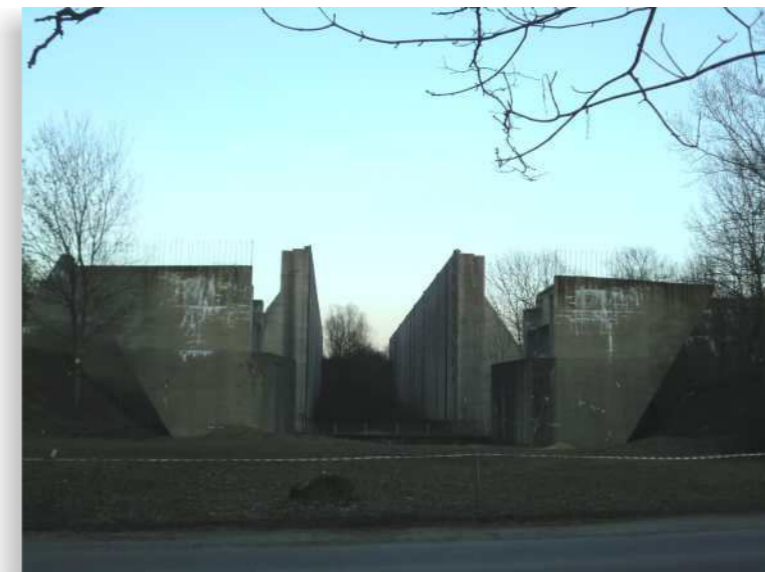
Abbildung 30 Schleusenruine nördlich Wüsteneutzsch Quelle: LA DÄRR; 24.02.2011
