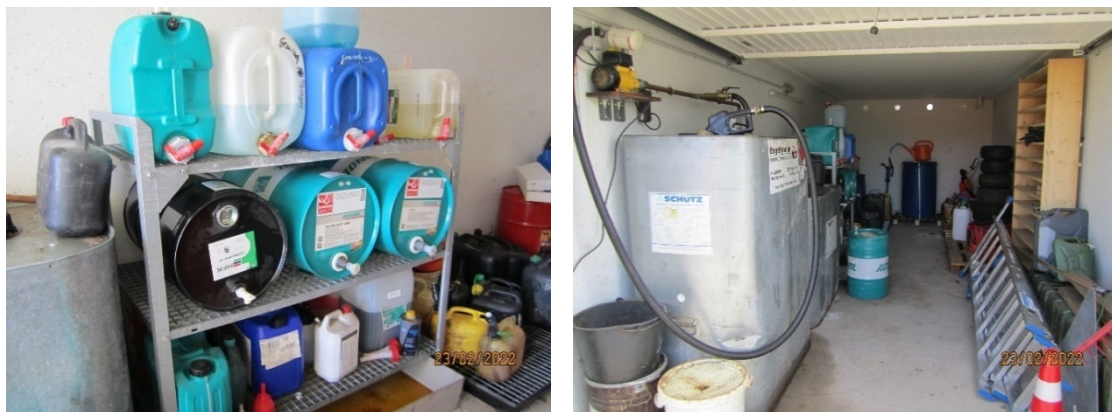
Abbildung 3-29: Tankstelle der Servicestation
